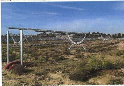
Exemple de structure trackers
